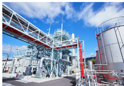
柳井本社工場 液中燃焼設備（新設）
