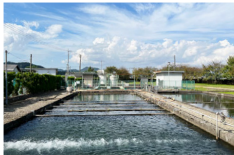
武生工場排水処理設備
